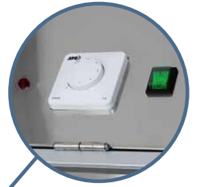
Ovládání ventilátoru a osvětlení
